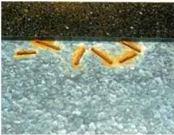
Abb. 4: Reste von Schweißelektroden können sog. "Fremdrost" verursachen
