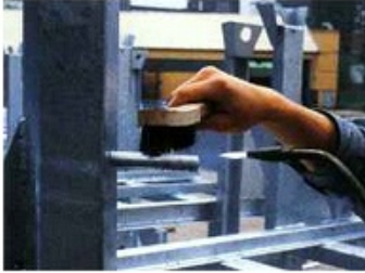
Abb. 3: Gewinde werden wieder gängig, wenn man das Zink im Gewinde erwärmt, es verflüssigt und dann ausbürstet
