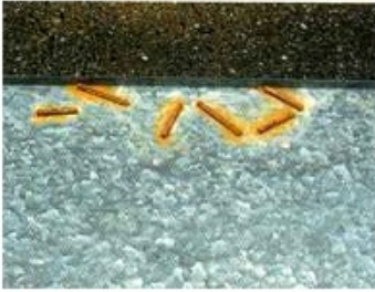
Abb. 4: Reste von Schweißelektroden können sog. "Fremdrost" verursachen
