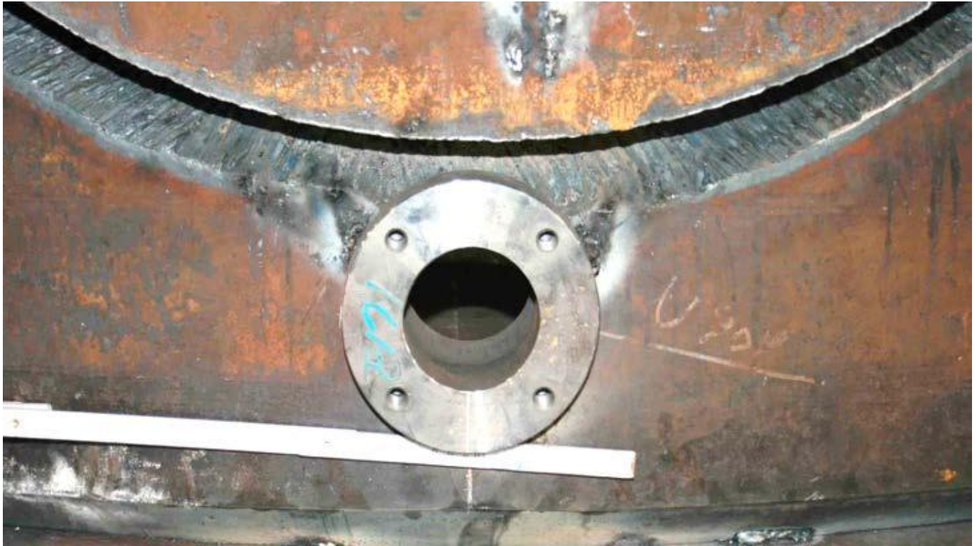
Bild 3: Nahtvorbereitung mangelhaft, Schweiß- und Zusammenbaufolge nicht beachtet.
