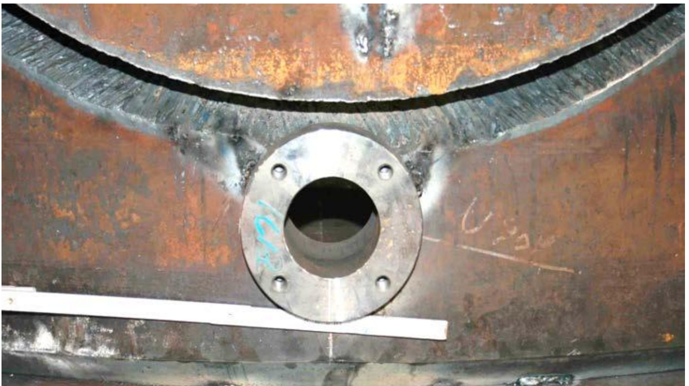
Bild 3: Nahtvorbereitung mangelhaft, Schweiß- und Zusammenbaufolge nicht beachtet.
