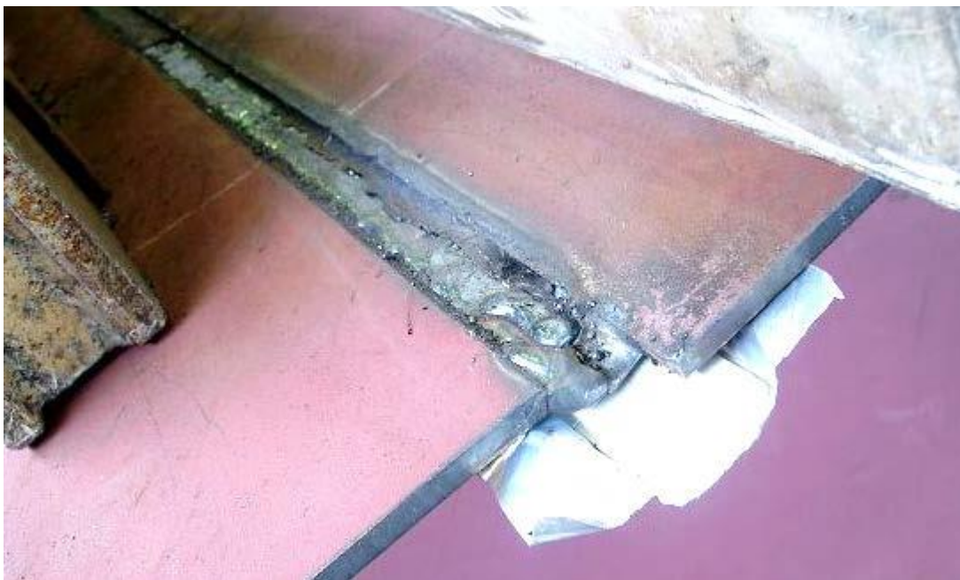
Bild 4. Sichtprüfung während des Schweißens, Riss in Zwischenlage
