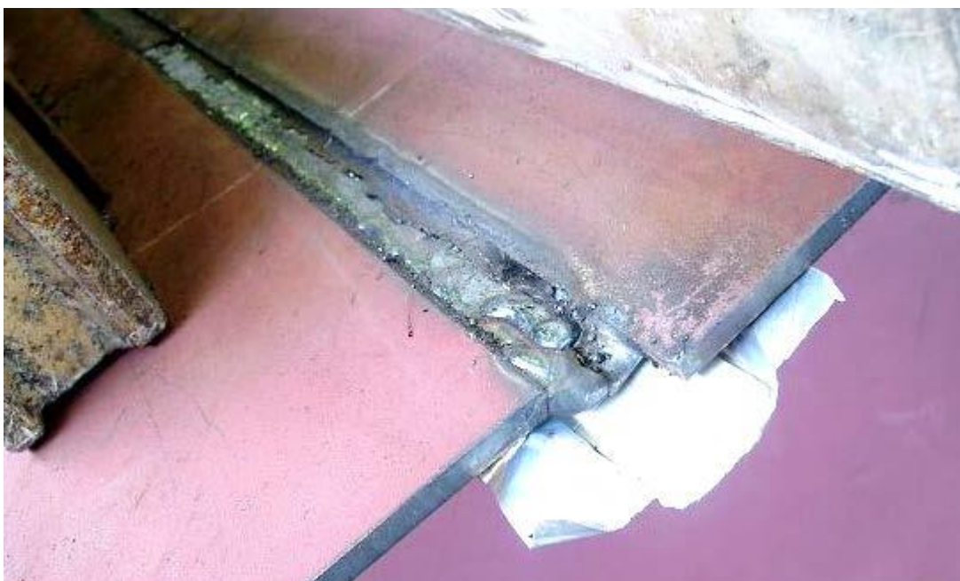
Bild 4. Sichtprüfung während des Schweißens, Riss in Zwischenlage
