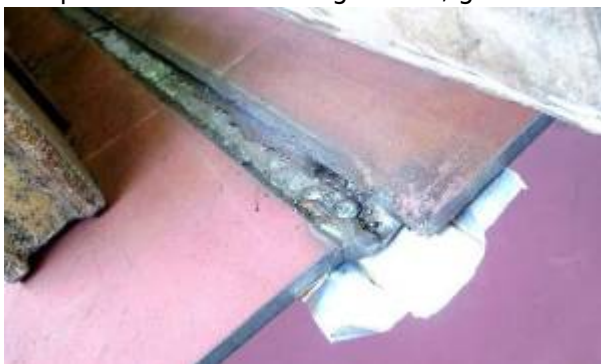
Bild 4: Sichtprüfung während des Schweißens, Riss in
