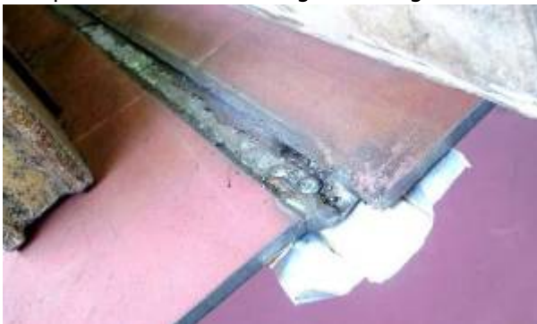
Bild 4: Sichtprüfung während des Schweißens, Riss in
