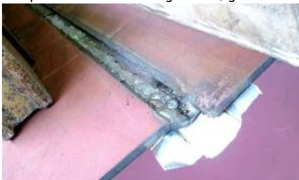
Bild 4: Sichtprüfung während des Schweißens, Riss in
