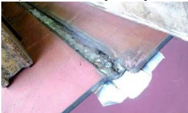
Bild 4: Sichtprüfung während des Schweißens, Riss in
