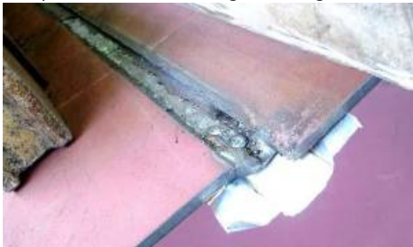
Bild 4: Sichtprüfung während des Schweißens, Riss in
