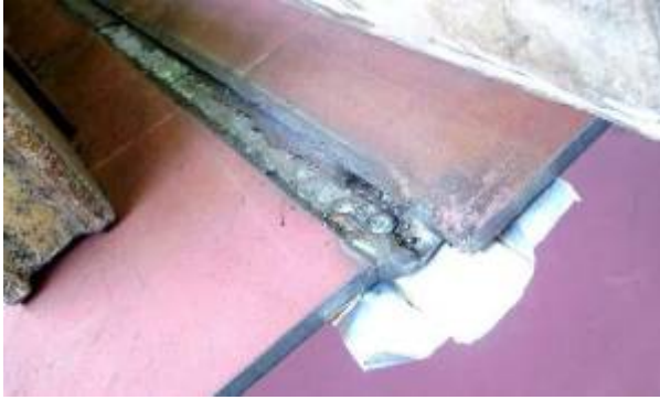
Bild 4: Sichtprüfung während des Schweißens, Riss in
