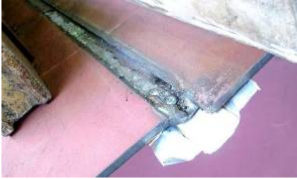
Bild 4: Sichtprüfung während des Schweißens, Riss in
