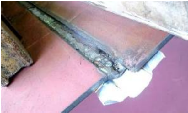
Bild 4: Sichtprüfung während des Schweißens, Riss in
