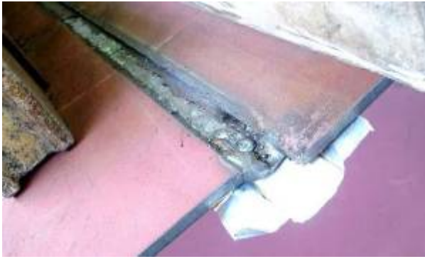
Bild 4: Sichtprüfung während des Schweißens, Riss in
