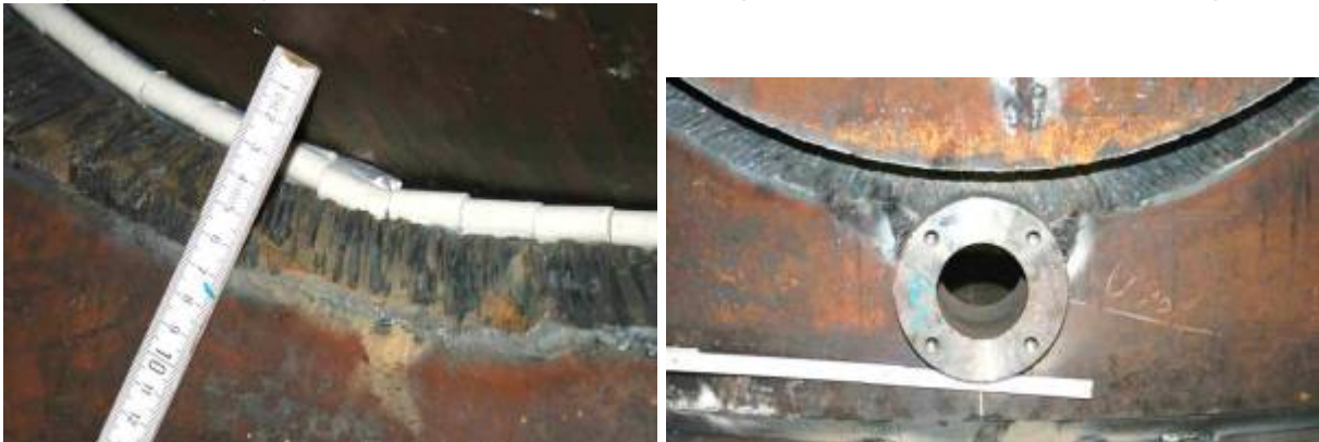
Bild 2: Nahtvorbereitung mangelhaft..... Bild 3: Nahtvorbereitung mangelhaft, Schweiß- und Zusammenbaufolge nicht beachtet.
